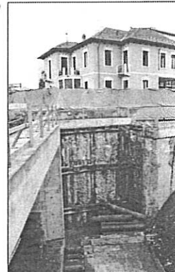
Opere di sostegno di tipo speciale per la realizzazione del sottopasso in località Rescaldina pronto per le operazioni di spinta
